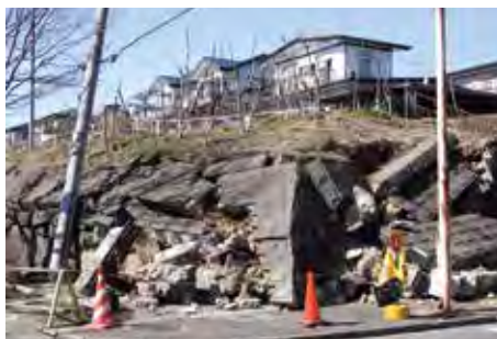
震災被害(蓬莱団地)
